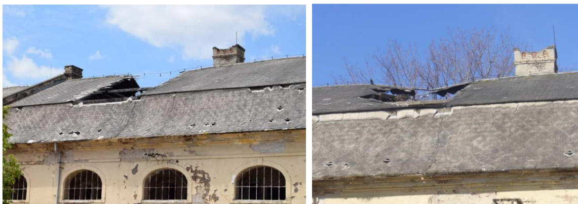
Obr. 5: Havarijný stav strešnej konštrukcie pred obnovou v roku 2014, autor: Tóth, I.
