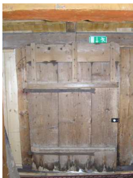
Obr. 3: Zatekanie pozorované na vchodových dverách, ktoré sú poškodené.
