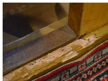
Obr. 4: Lišty lavíc, mechanicky poškodená drevná hmota.
