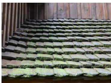
Obr. 2: Machom obrastené šindle na severnej strane kostola.
