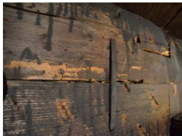
Obr. 14: Tmavé flaky na drevnom obložení empory so značným poškodením drevnej hmoty.
