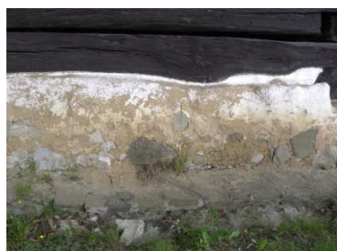
Obr. 7: Poškodená a opadaná omietka kamenného sokla.
