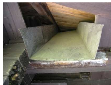
Obr. 22: Trám na južnej stene objektu poškodený v dôsledku vody stekajúcej z rímasy.
