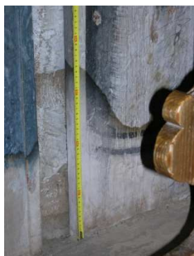
Obr. 17: Aktuálne zavlhávanie – stopy tvorené vlhkosťou a pôsobením vody siahajúce do výšky 40 cm lavice, južná strana.
