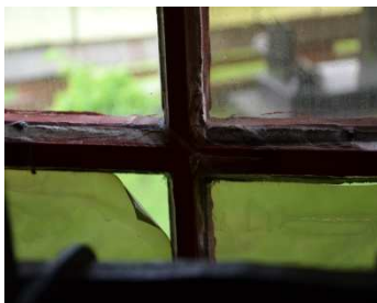
Obr. 15: Poškodená nepriliehajúca ochranná fólia na oknách.
