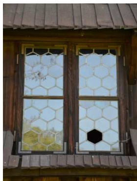
Obr. 8: Chýbajúci šesťuholník okennej výplne okna na východnej strane objektu.
