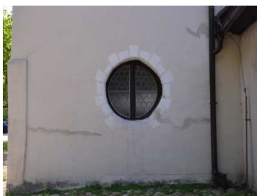
Obr. 11: Šetrne vyplnené trhliny v omietke na západnej stene severného ramena a vznikajúce nové trhliny.
