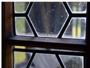
Obr. 9: Nepriliehajúca okenná kazeta k okennému rámu.
