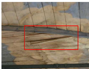
Obr. 12: Prečnievajúca uvoľnená doska z maľovaného stropu v mieste kríženia klenieb.
